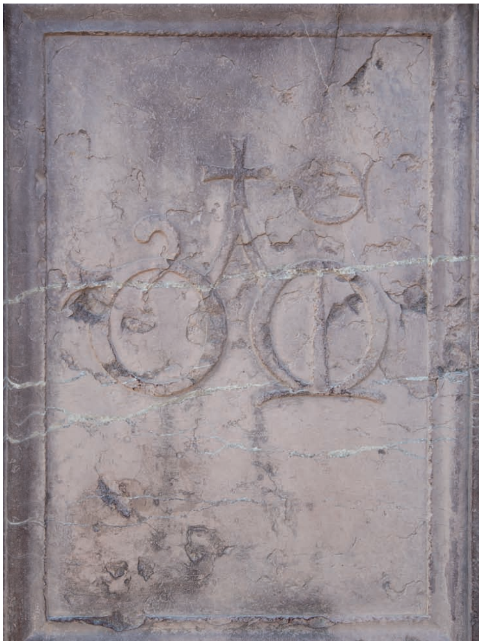
Formella del pozzo recante lo stemma dell'Ospedale di Santa Maria della Misericordia
